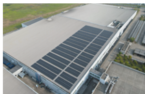
ファクトリー1(インドネシア) 工場屋上の太陽光パネル
